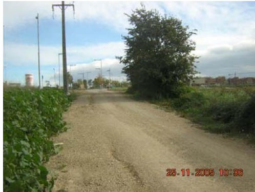
Tram 1: Estat del ferm
