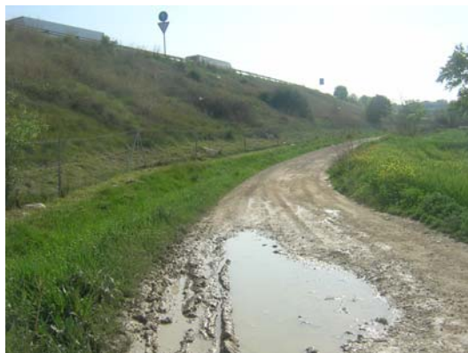
Tram 1: Estat del ferm
