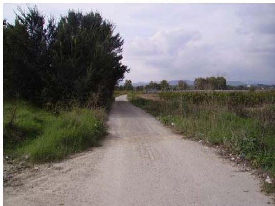
Tram 1: Estat del ferm
