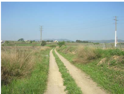
Tram 1: Estat del ferm
