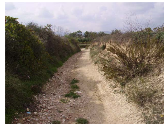
Tram 1: Estat del ferm
