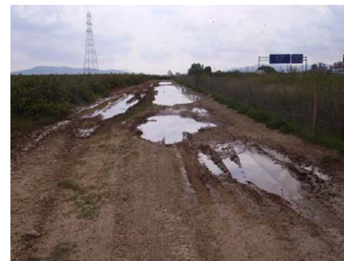
Tram 1: Estat del ferm
