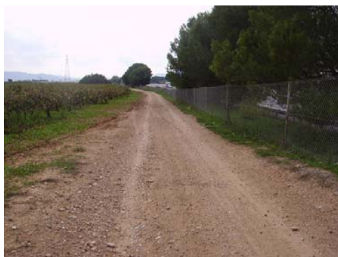
Tram 1: Estat del ferm
